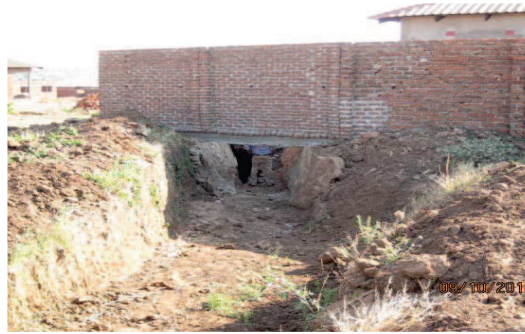
雨水排水路計画がないため、住宅敷地を水路が通過 LCCはそのまま側面2面張り水路として黙認する模様
